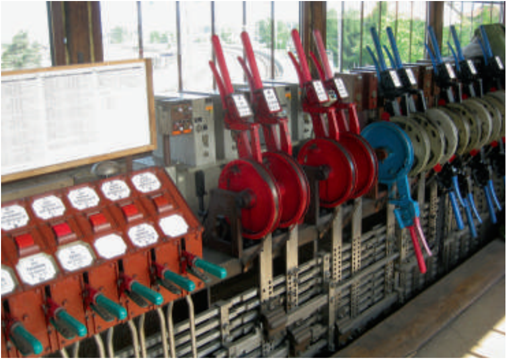
Rechts des Rollenblocks befindet sich die Hebelbank mit den Signal- und Weichenhebeln, darunter das mechanische Verschlussregister.
